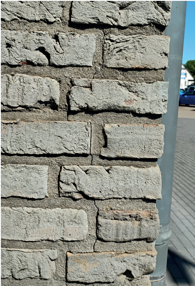
Klinkerfassade ohne Eckfuge mit Rissen
