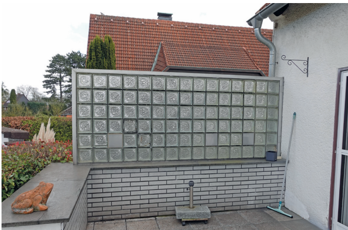
Sichtschutzwand mit Glasbausteinen – Zwangsspannungen haben Glasbruch verursacht
